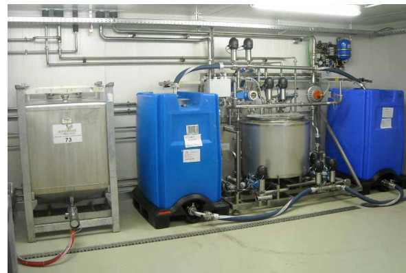
↑ Zařízení na dávkování droždí z kontejneru s rozvodem po pekárně a automatickým dávkováním. Součástí zařízení je i dávkování vaječné melanže (vlevo).
